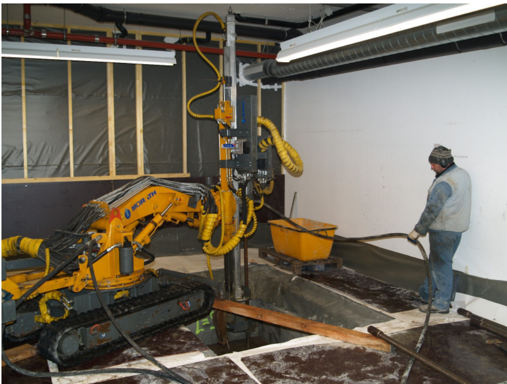
In den Räumen des Zentrallagers wurden die bis zu zehn Meter tiefen Pfahlbohrungen durchgeführt.
