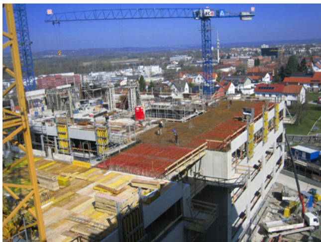
Die roten Leitungen dienen der Temperierung der Räume.
