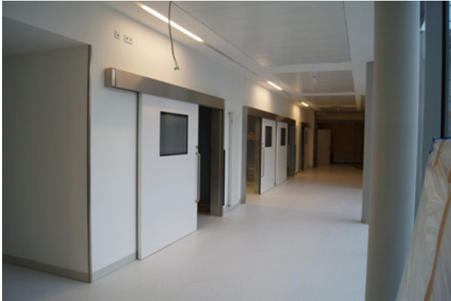
Der Verbindungsbau West wird im April an die OSK übergeben. Der Innenausbau ist schon weit fortgeschritten.
